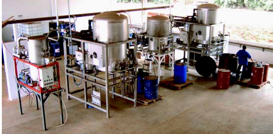
Usina de reciclagem de solventes Solvent Recycling Plant
